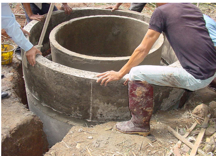
ภาพการสร้างบ่อแก๊สโดยใช้ท่อคอนกรีต เส้นผ่าศูนย์กลาง 1.50เมตรเป็นบ่อชั้นนอก
